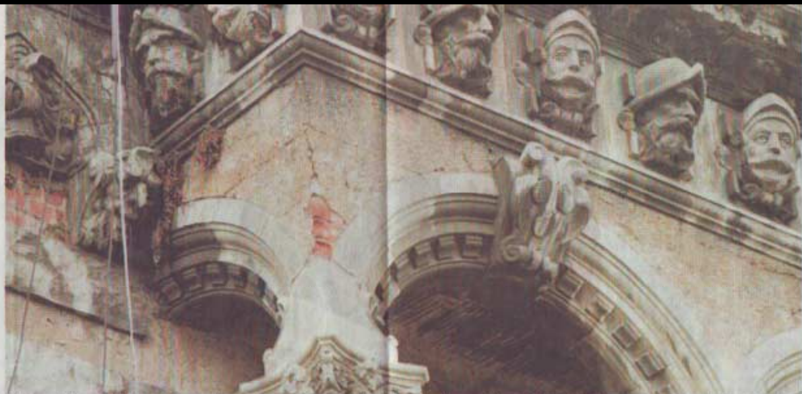
Schönheit schützt vor Abriss nicht: Wegen des üppigen Figureschmucks als „Märchenhaus“ berühmt, verfiel trotzdem in Leipzigs Innenstadt ein einzigartiger Bau der Jahrhundertwende. Überhöhte Preisforderungen verhinderten einen Verkauf samt Instandsetzung. Ein Dachstuhlbrand gab kürzlich Anlaß, das Gebäude niederzuliegen. Foto: Stefan Pütz
